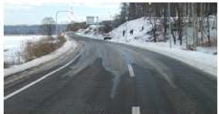
一部凍結した道路
